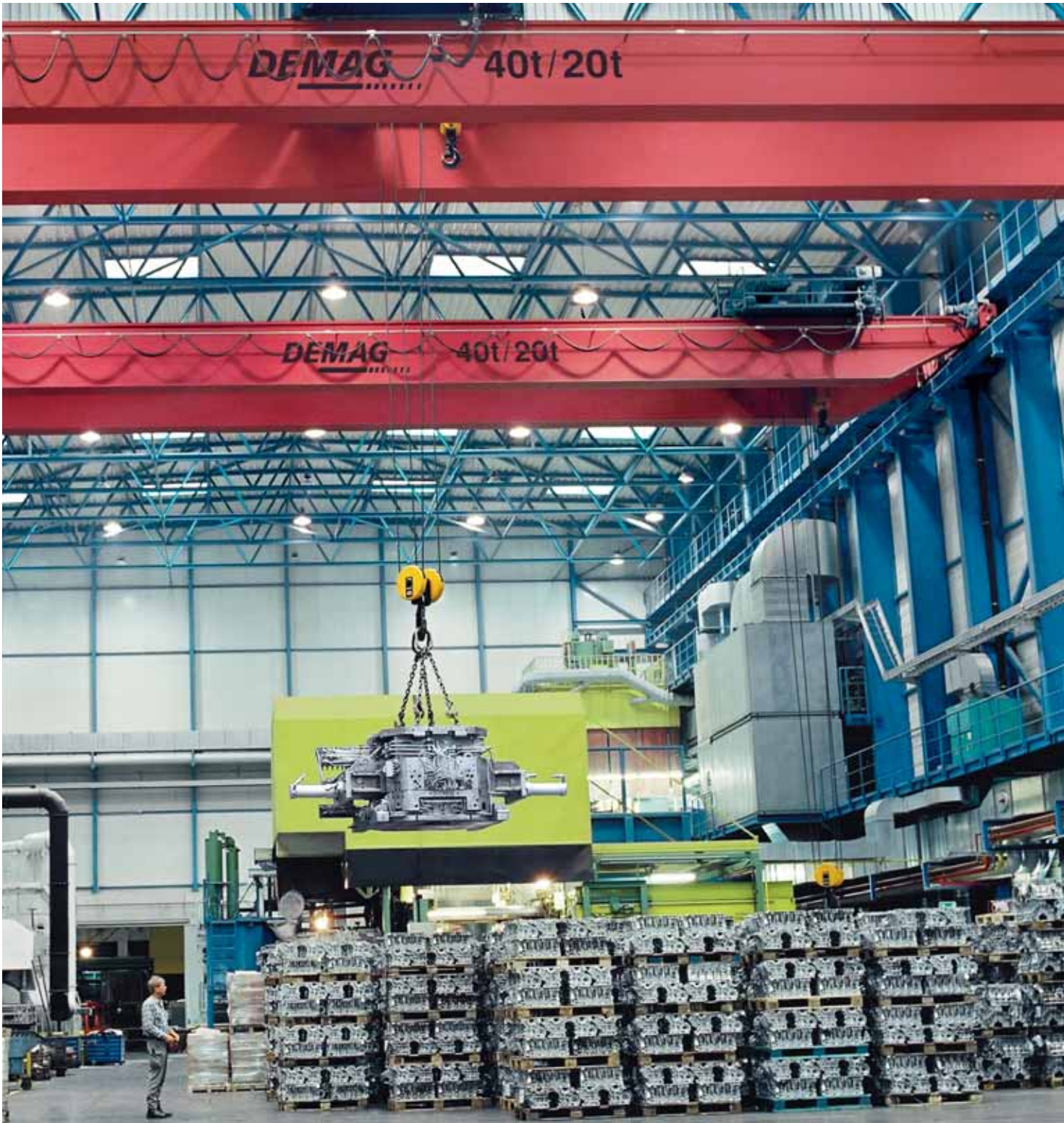
Tvåbalkstravers med tandemdrift för att transportera och vända motorblock.
