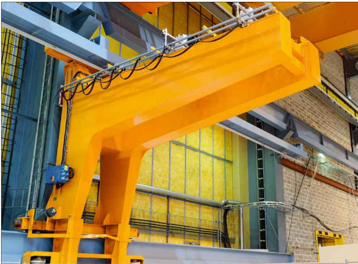
Bilden visar en av de väggkonsolkranar som Dematek byggt om i samband med leveransen till Siemens Industrial Turbomachinery.
