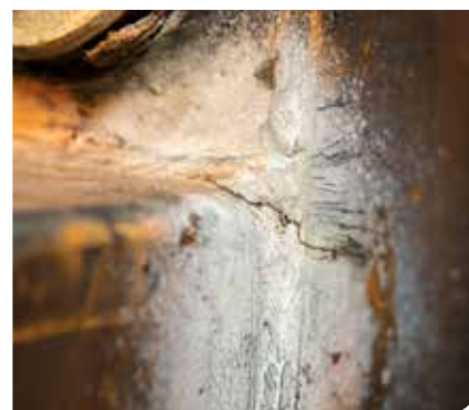
Vid konditionsanalysen hos Uddeholm upptäcktes bland annat sprickor i kranens stålkonstruktion.
